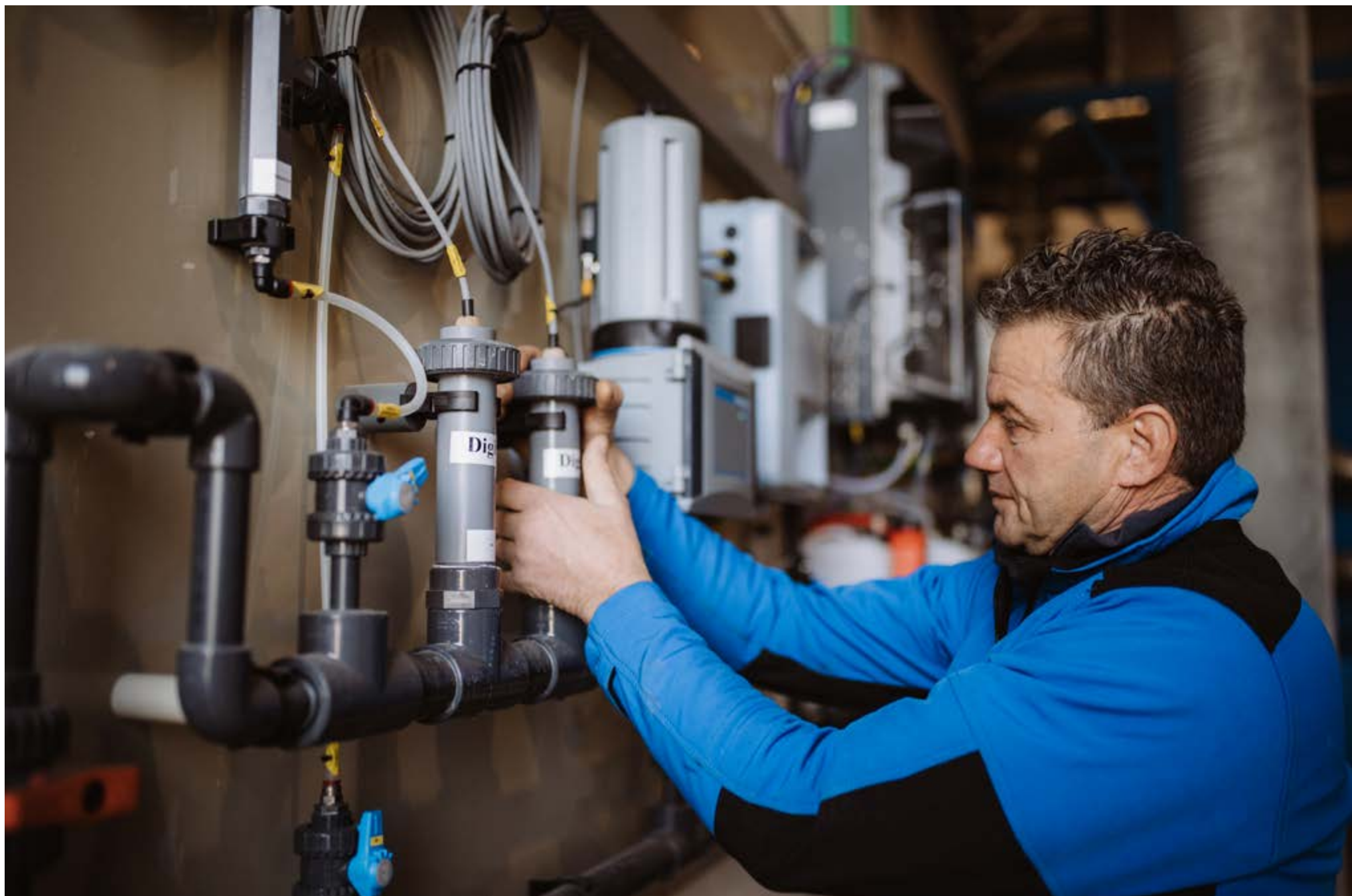
Tecnico operativo del servizio adduzione
