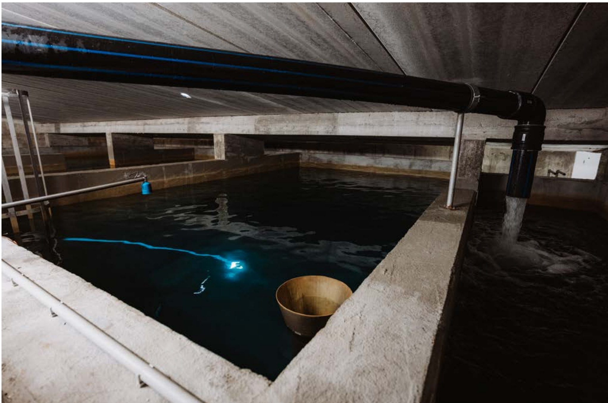
Vasca di arrivo dai pozzi di captazione. Impianto di soccorso di Castel Trosino, Ascoli Piceno.
