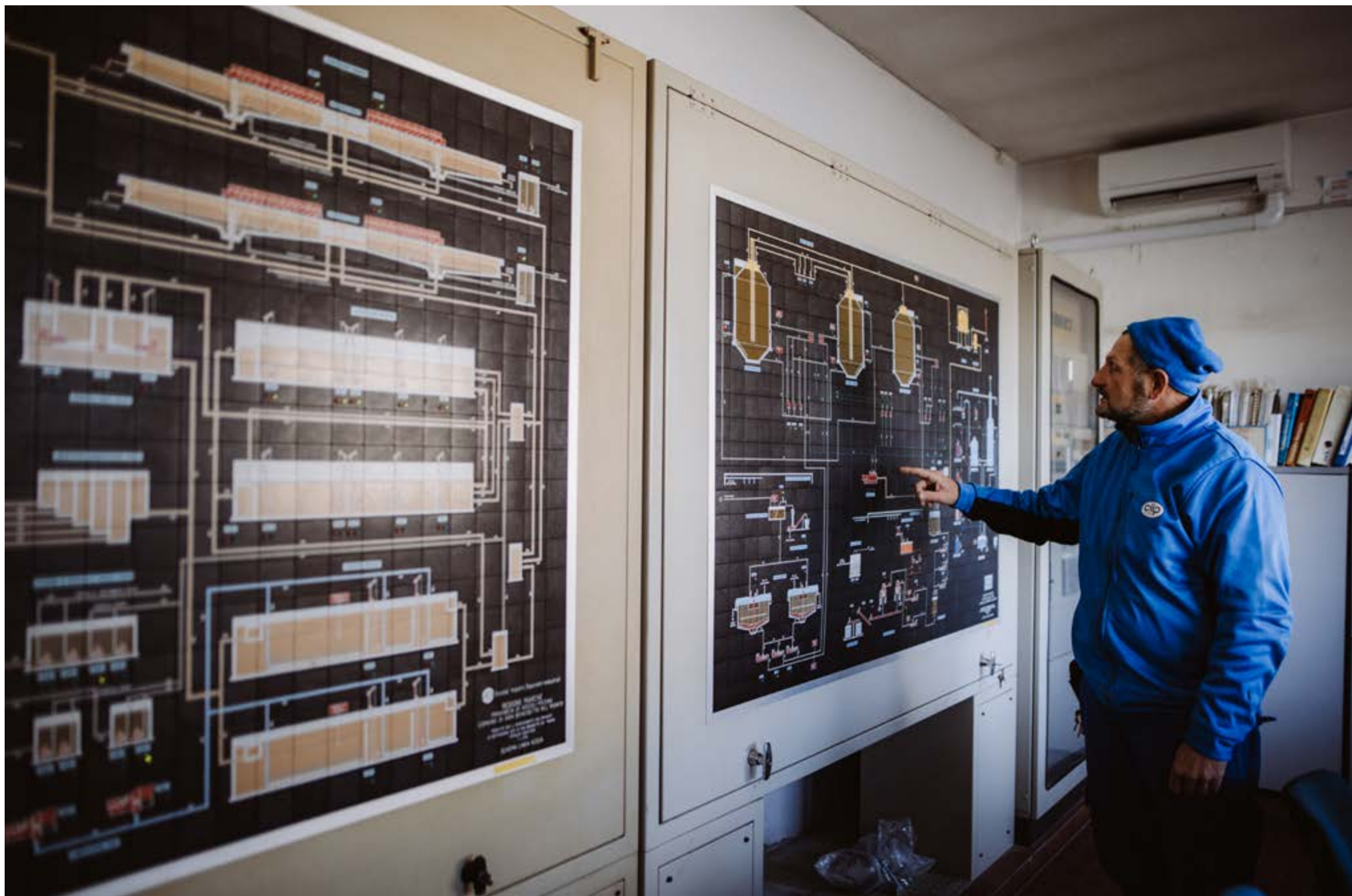
A fianco: vasca biologica dell'impianto di depurazione Salvano, Fermo. In alto: pannello di controllo dell'impianto di depurazione Brodolini, San Benedetto del Tronto.
