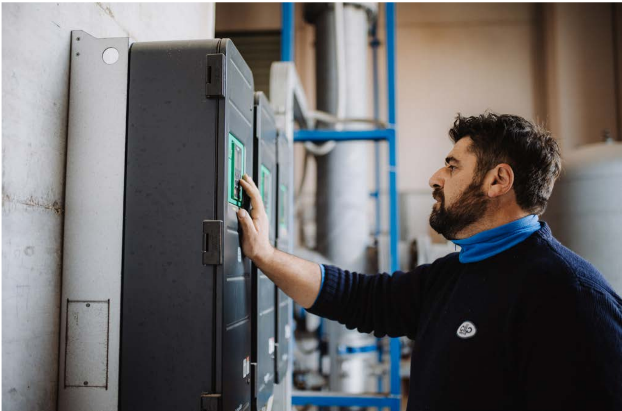
Tecnico operativo del servizio adduzione
