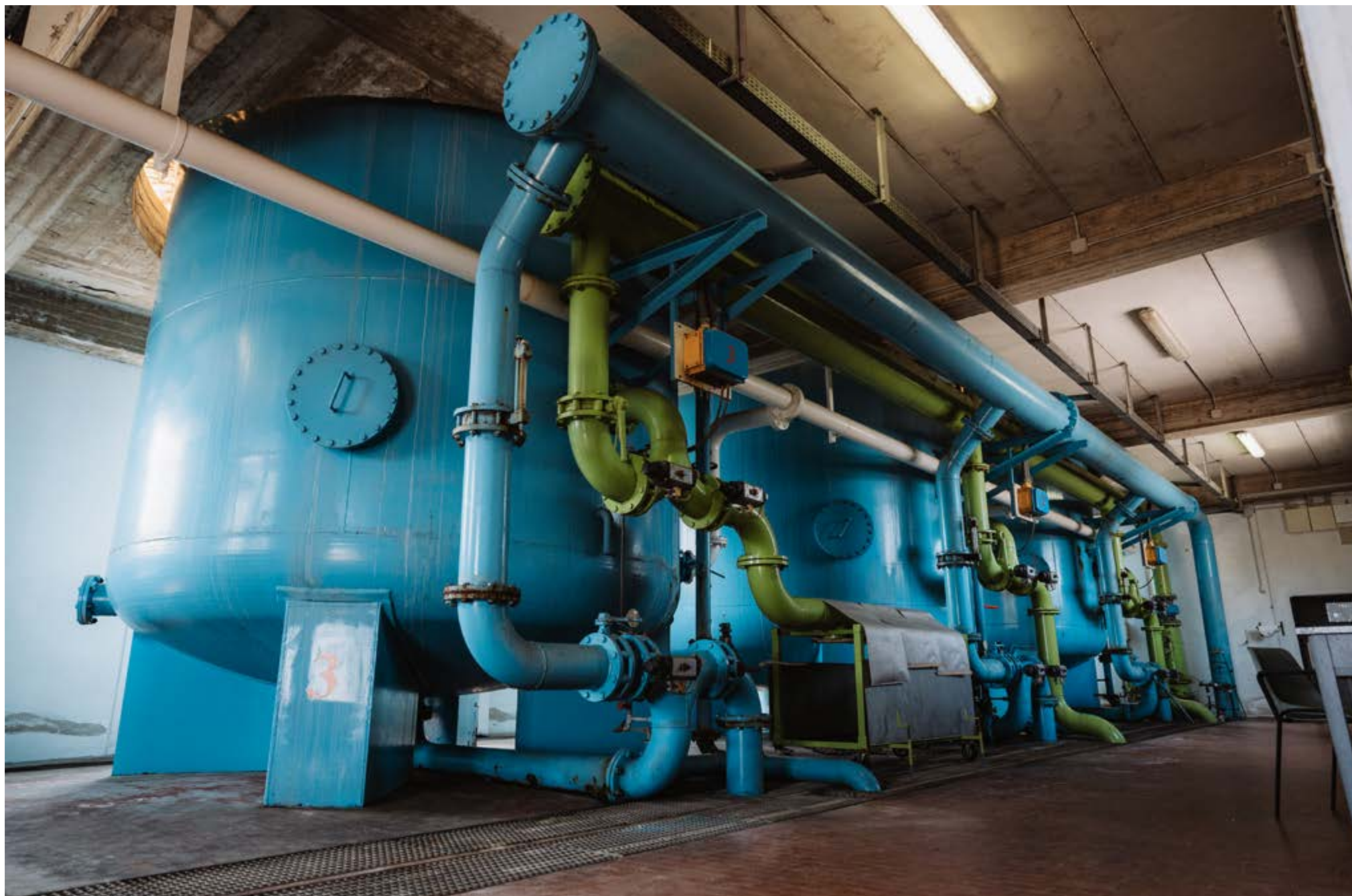
Filtri a carboni attivi dell'impianto di soccorso Santa Caterina, Fermo.
