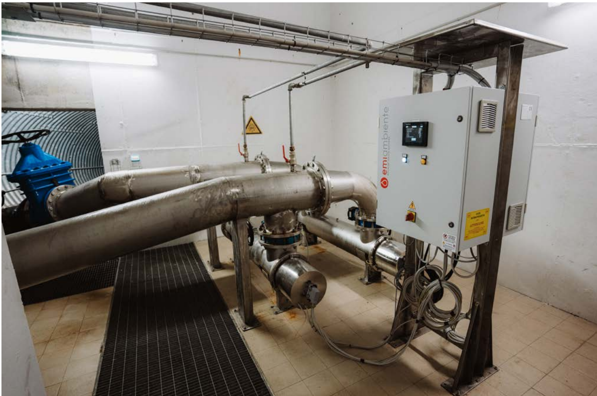
A fianco e in alto: sistema di debatterizzazione. Impianto di soccorso di Castel Trosino, Ascoli Piceno.
