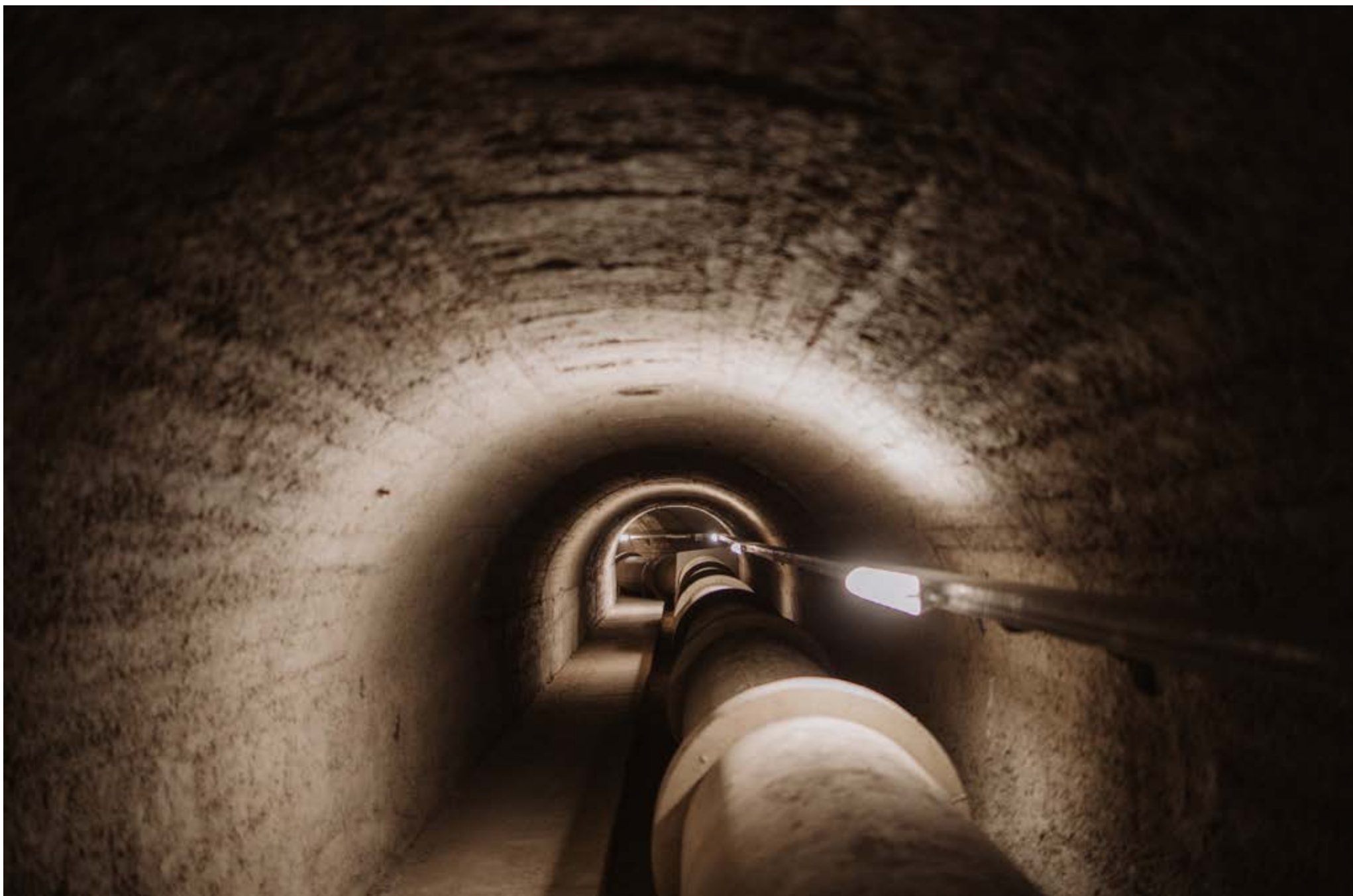
A fianco: tecnico del servizio adduzione. In alto: ingresso galleria sorgente Pescara del Tronto, Comune di Arquata.
