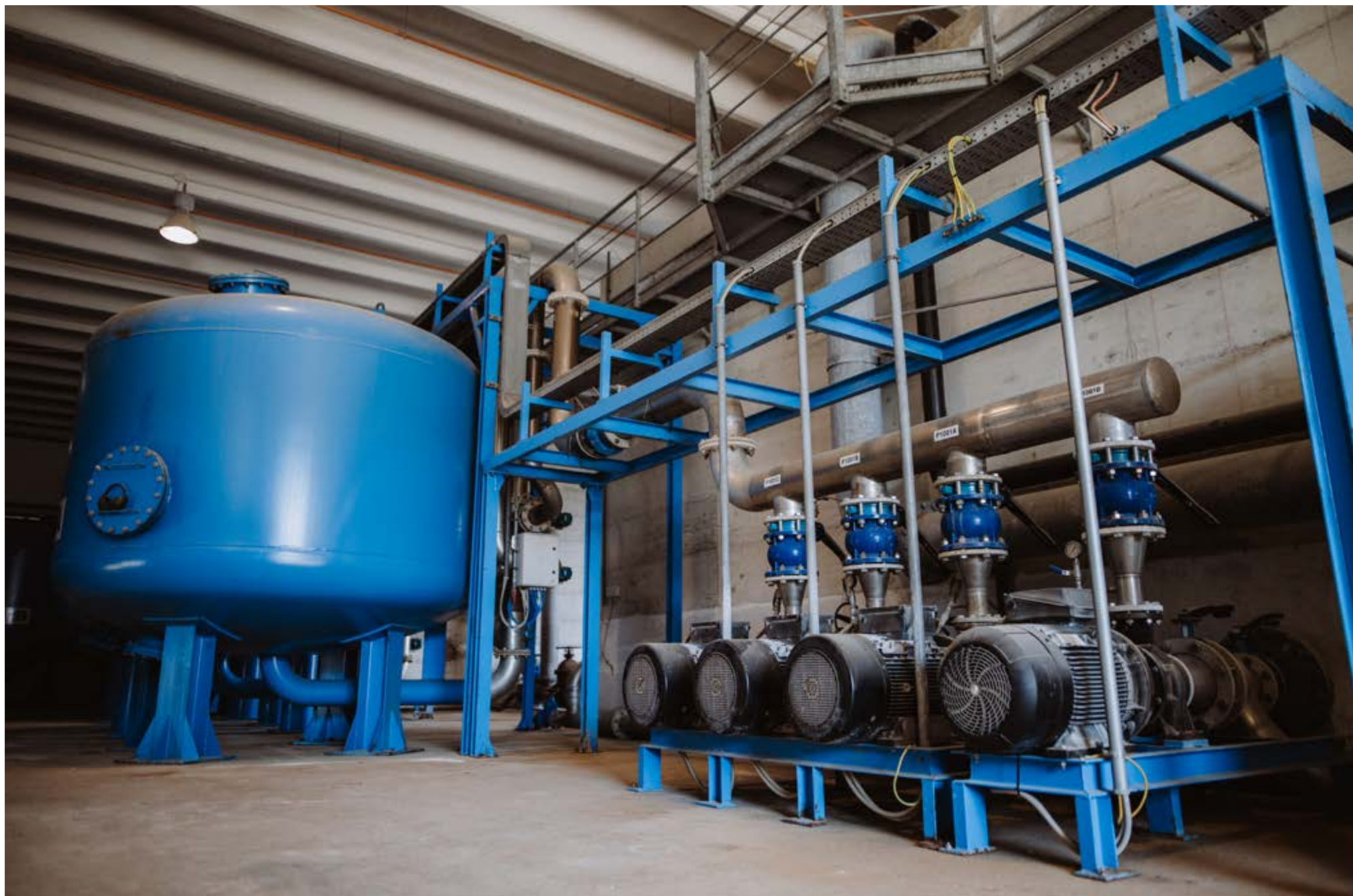
Sezione di ingresso al trattamento di potabilizzazione. Impianto di soccorso Fosso dei Galli, San Benedetto del Tronto.
