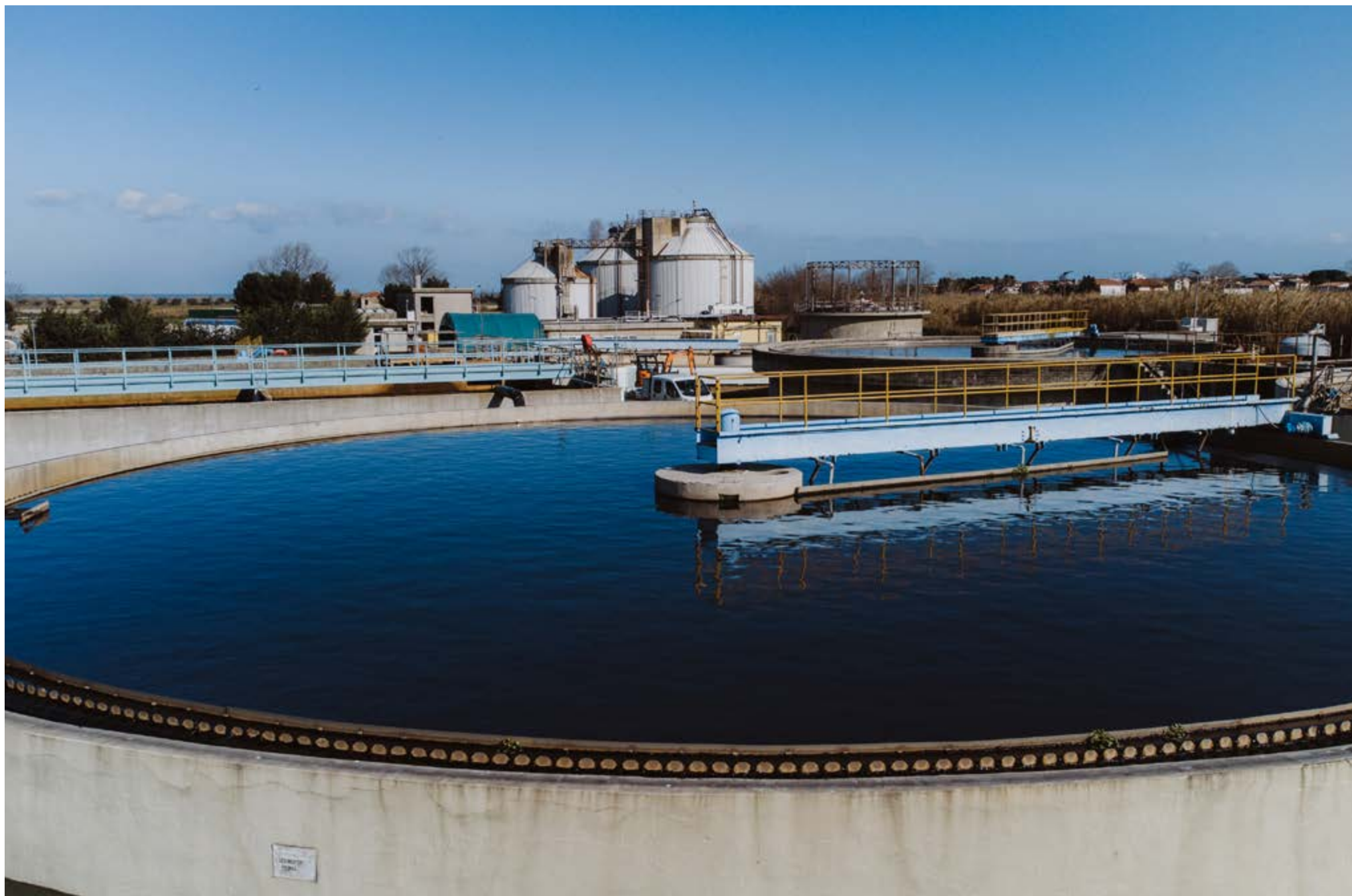
Sedimentatore secondario dell'impianto di depurazione Brodolini, San Benedetto del Tronto.
