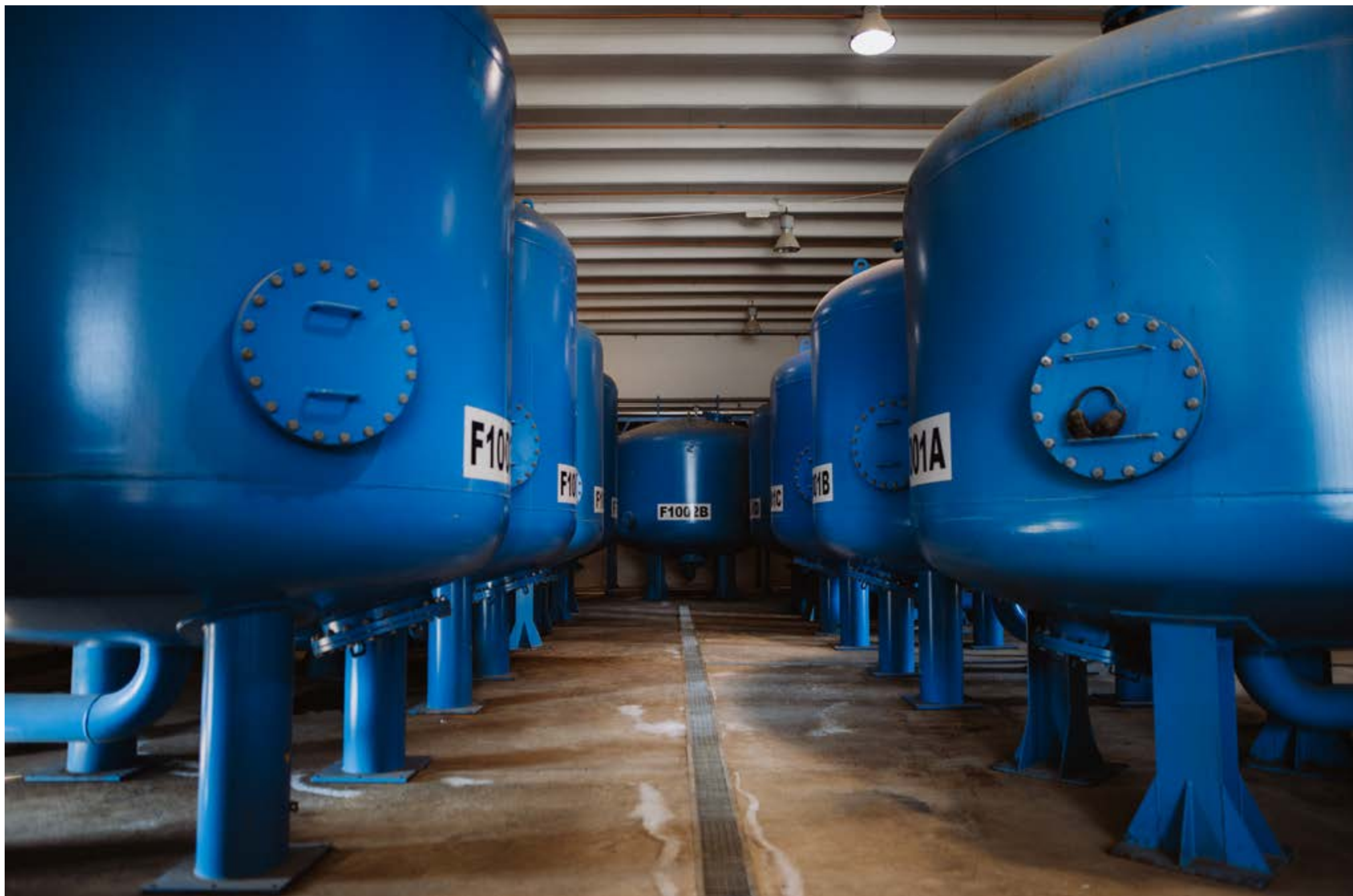
Filtri a sabbia dell'impianto di soccorso Fosso dei Galli, San Benedetto del Tronto.
